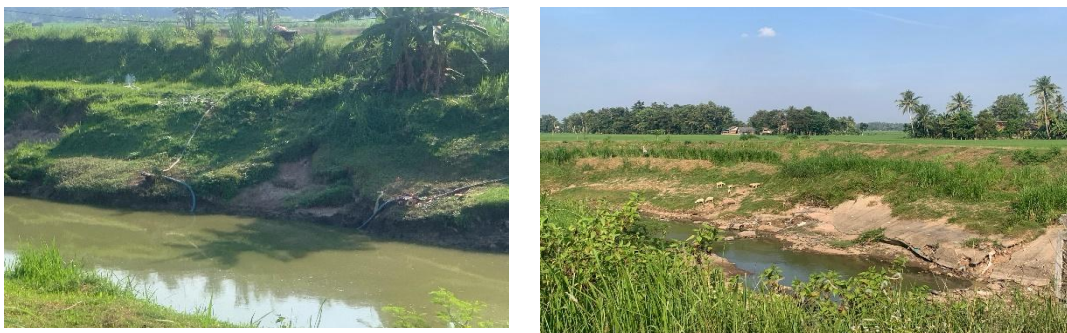
Gambar 3. Kondisi tanggul sungai di Kecamatan Candipuro
