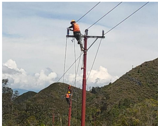
Gambar 2. Bentangan Jaringan Tegangan Menengah (JTM) yang telah terbangun melintasi lanskap perbukitan distrik ibele
